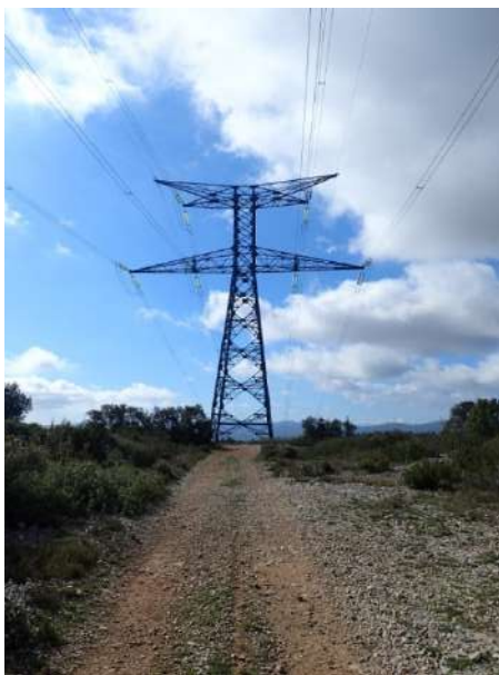
Ligne HTA présente sur les terrains du projet (source : photo SOE)
