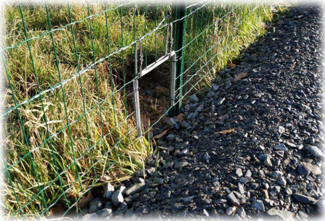
Figure 54. Exemple de passage à faune – CERMECO
