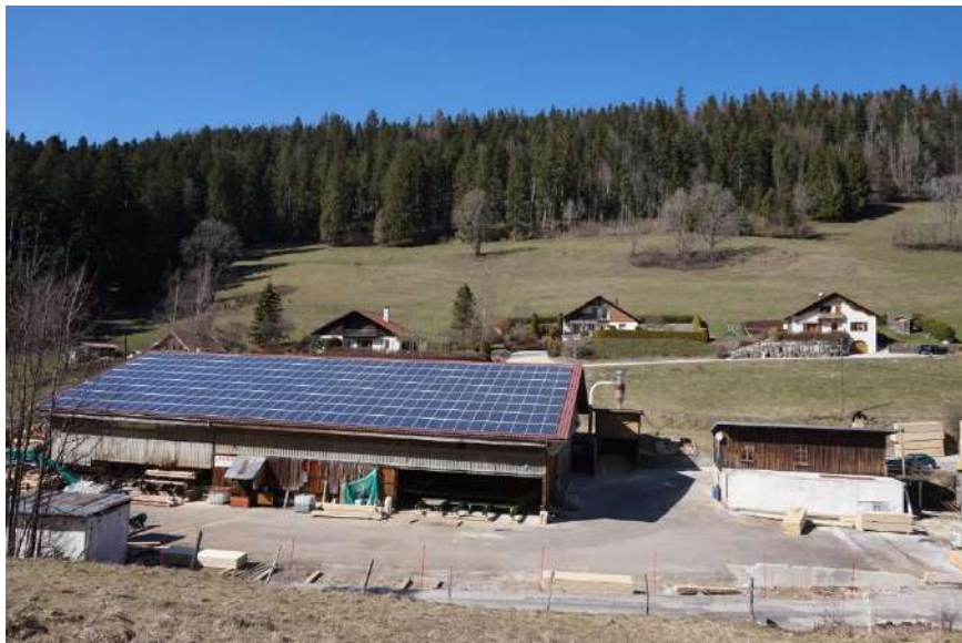
Photo n°3. Installation photovoltaïque sur la commune de Montlebon
