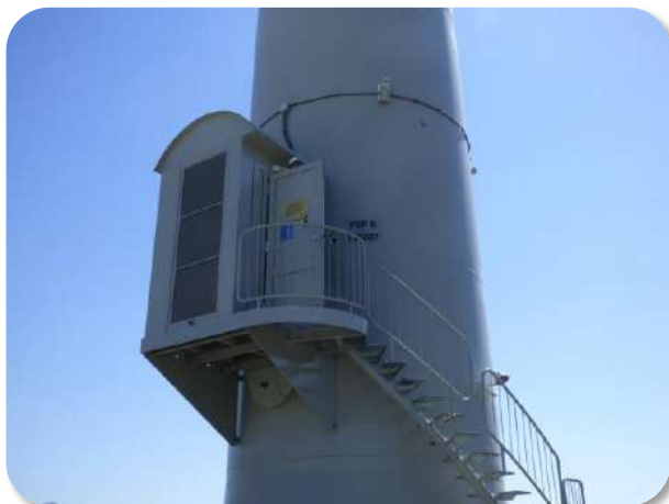
Eolienne E8 équipée
