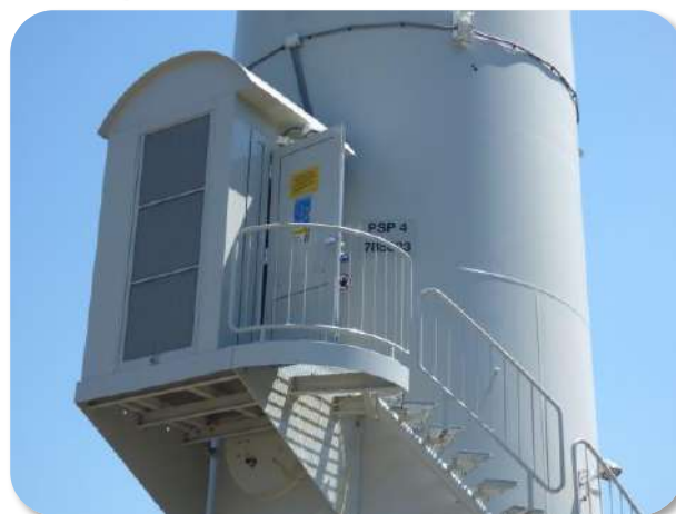
Eolienne E4 équipée
