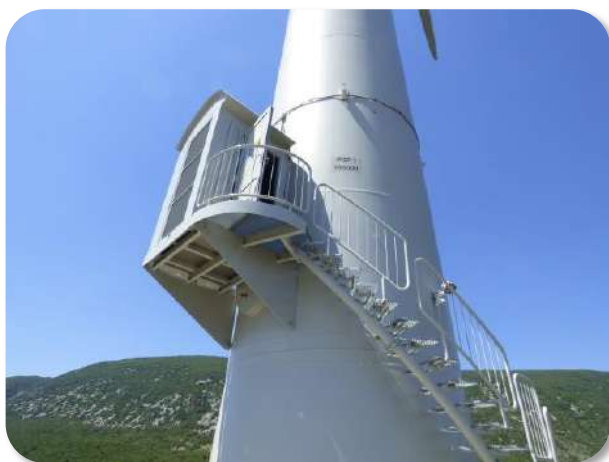
Eolienne E1 équipée
