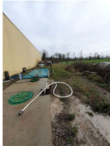
débourbeur/déshuileur utilisé pour traiter l'eau issue du sciage et du dispositif de prélèvement
